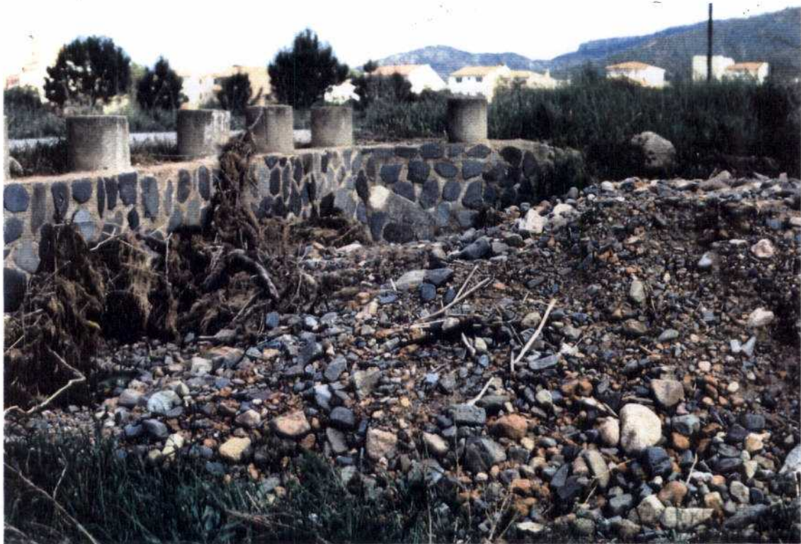
Foto 5.-Puente de tuberías sobre el río Sec (camino de Milmanda). Efectos de la avenida de Semana Santa de 1991.
